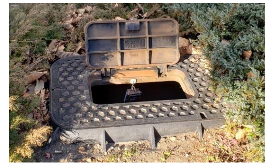
電波の減衰を確認した 鉄製のメータボックス
