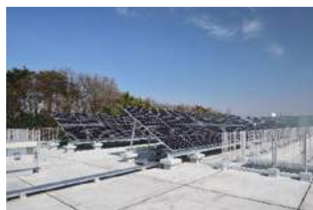
太陽光パネルを設置した例
