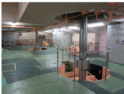
多摩川第一発電所
