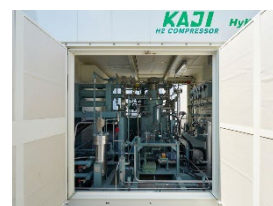
水素圧縮機（コンプレッサー）
