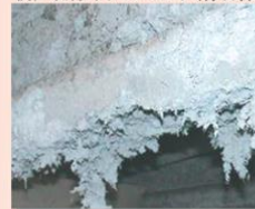
例) 吹付けアスベスト(青石綿)
