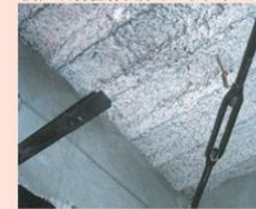
例) 石綿含有吹付けロックウール
