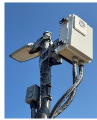
遠隔監視システム
