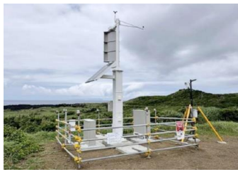
小型風力発電機全体
