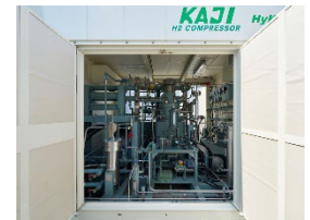
水素圧縮機 （コンプレッサー）
