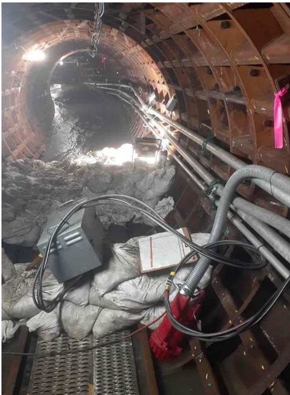
トンネル内の土砂流入状況
