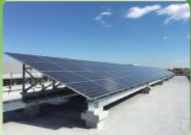
都立学校への太陽光発電設備の導入
