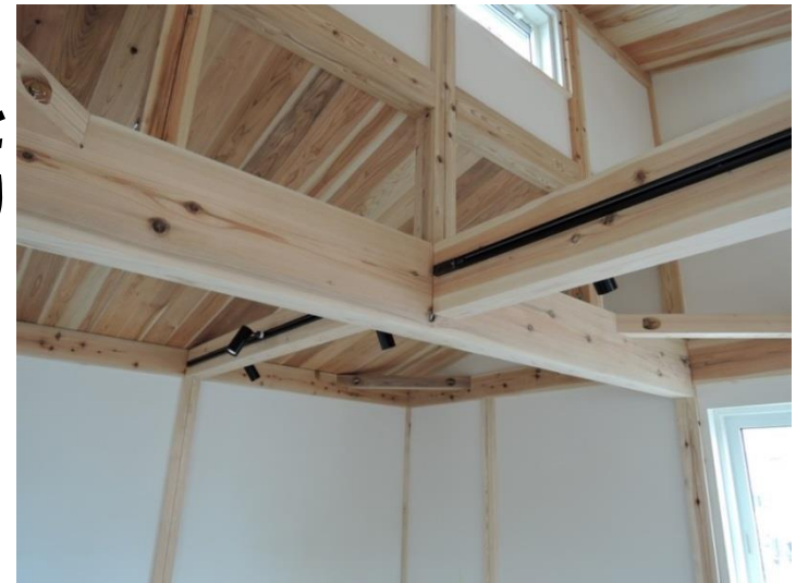
内装（多摩産材の梁など）
