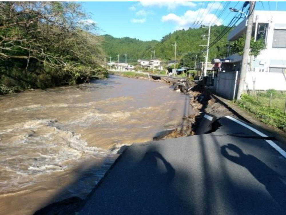
＜日の出町＞ 平井川により洗掘された都道184号線
