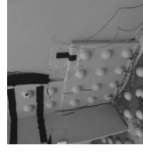
き裂センサーの開発 発・橋梁への貼付実証 実験を実施中
