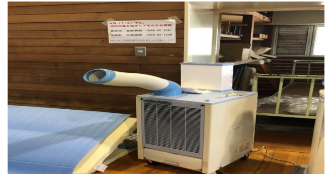
平成30年7月豪雨時の避難所に設置された冷房
