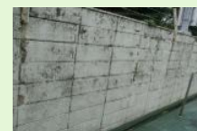
対策が必要なブロック塀
