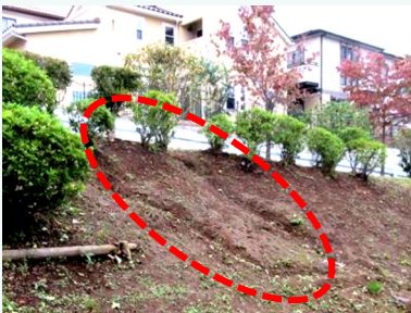
▲のり面の浸食 崩落の恐れがある
