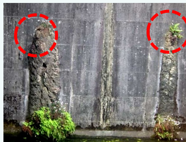
▲水抜き穴からの土砂流出 裏込め土の流出による地盤沈下や排水機能不全による盛土の不安定化の恐れがある
